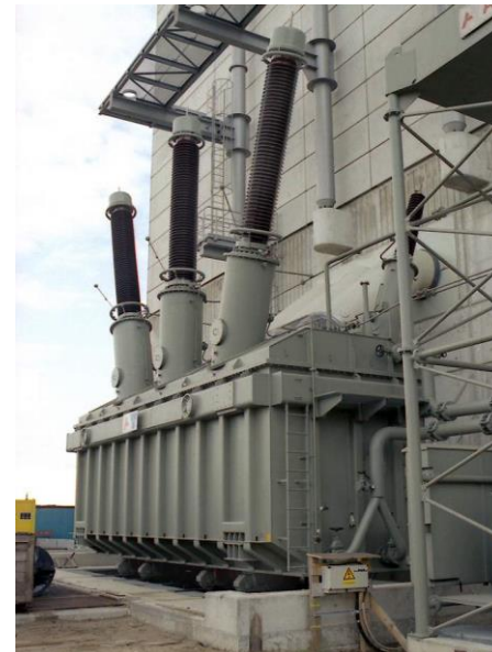
Сейсмоизоляция мощного трансформатора
